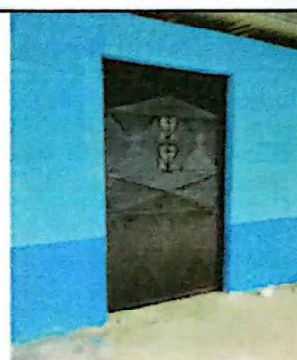
Foto 4: PUERTAS DE METAL
